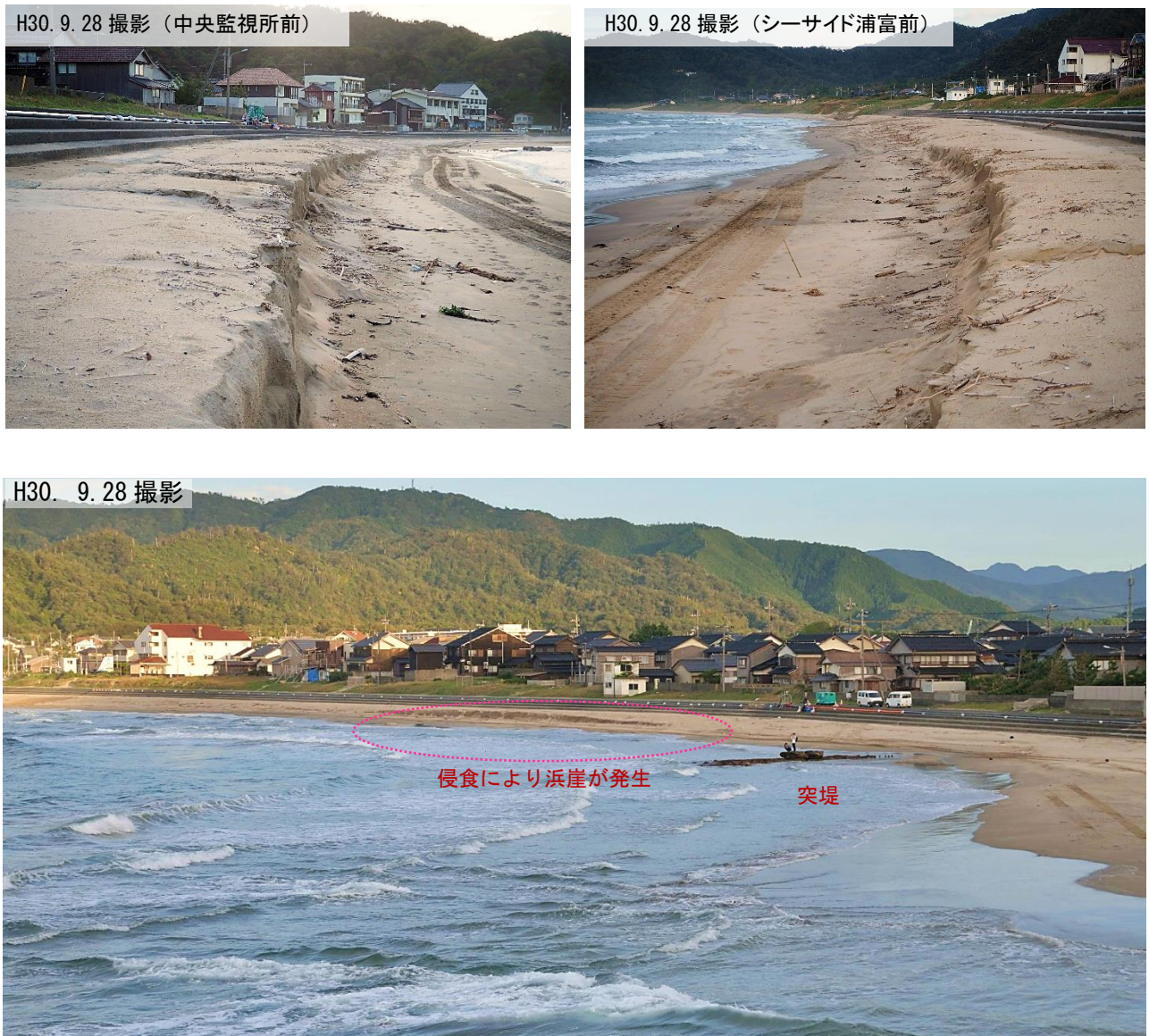
図 5.1.1 岩美海岸（浦富地区） 侵食状況写真
